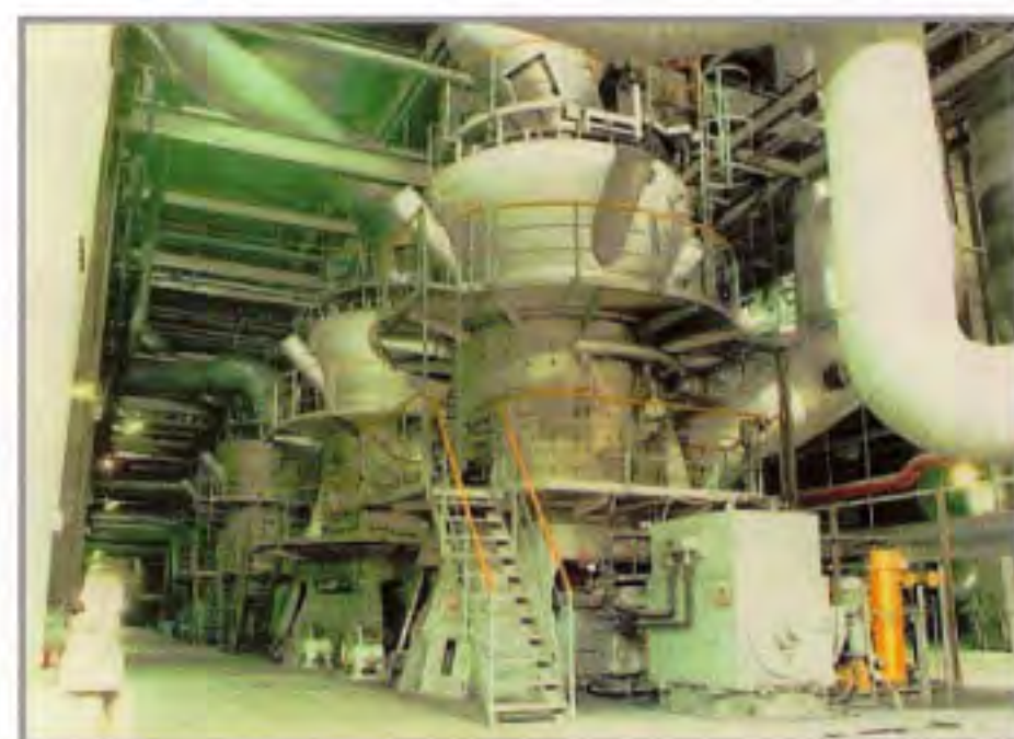
中速磨煤机 Medium speed coal mill
